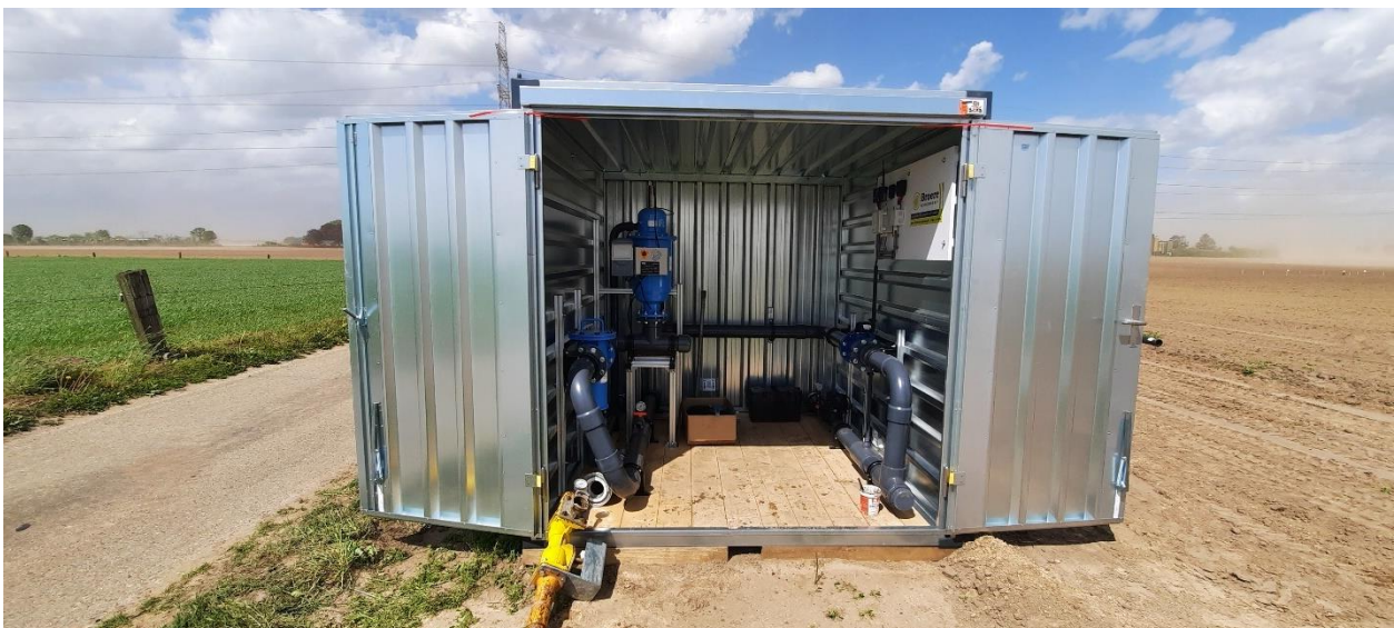
Figuur 4: Mobiele installatie met filters, drukverlager en sturing
