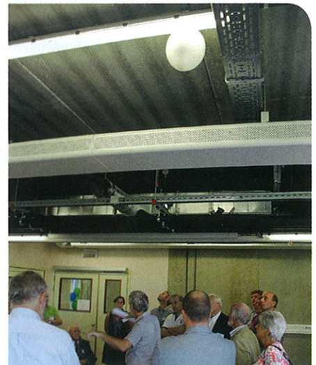
In deze klimaatbalk circuleert warm (35-40°C) of koud (14-16°C) water in functie van de behoefte.
